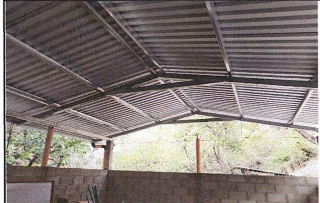
Foto 2: Mejoramiento de techo de estructura metalica tipo portico con láminas troqueladas calibre 26, finalizado.
